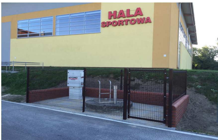
Pompownia ul. Myśliwska Włoszakowice
