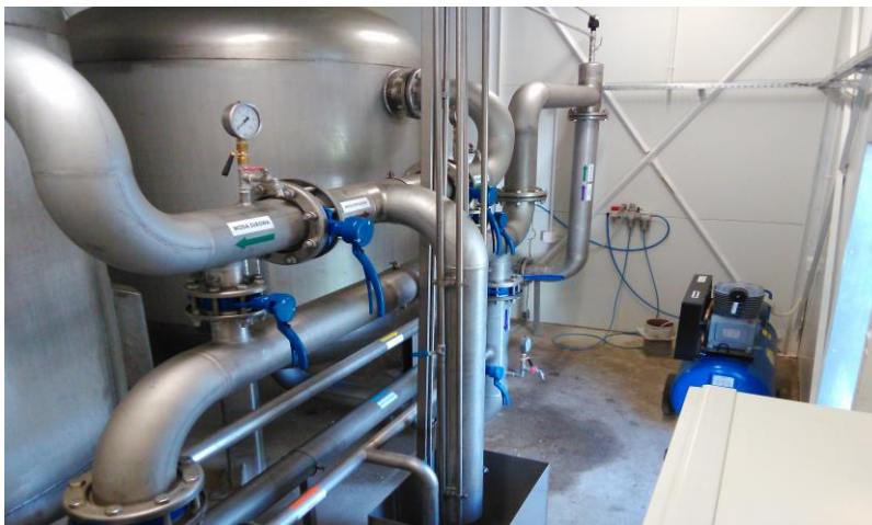
Wnętrze Kontenerowej Stacji Uzdatniania Wody
